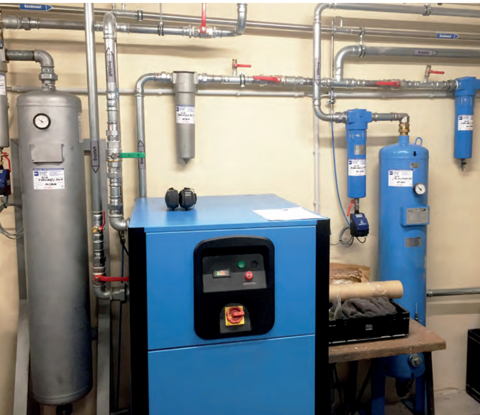
Die Druckluftaufbereitung: Vier moderne Kompressoren erzeugen gemeinsam mit den INMATEC Stickstoffgeneratoren flexibel bis zu 100 m 3 Stickstoff pro Stunde.
