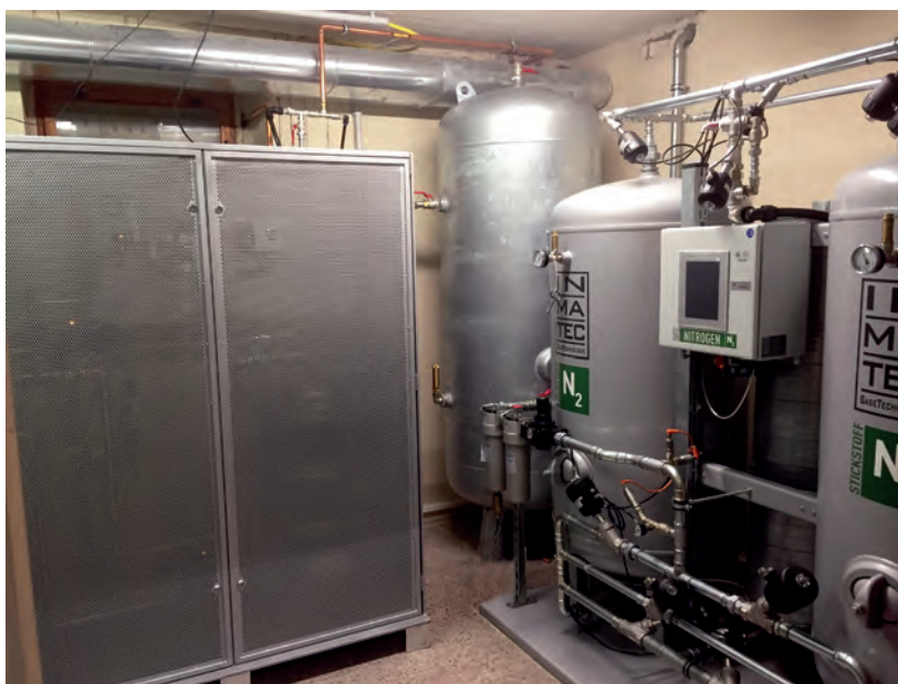
Einer der beiden PN 2250 Generatoren von INMATEC (rechts) mit Wasserstoff-Katalysator NKat 060 im Schrank (links).
